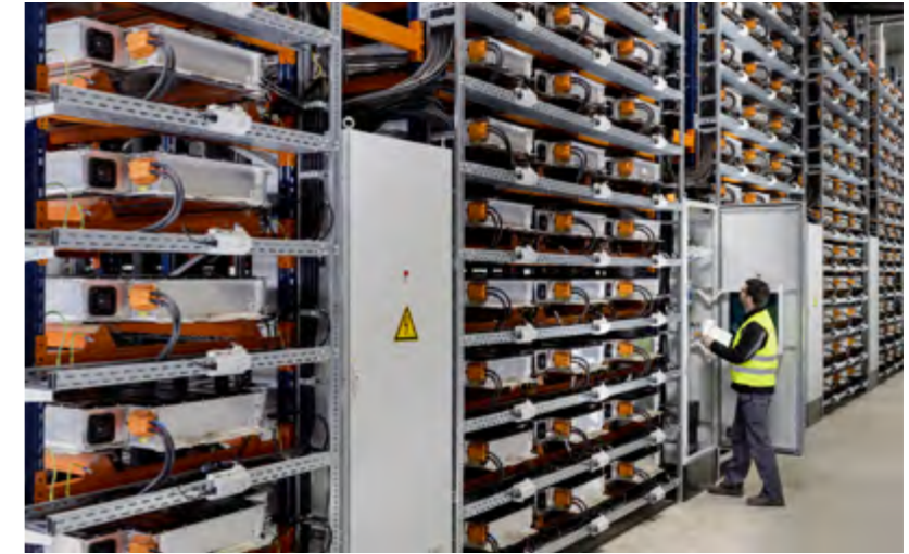
Innovative, nachhaltige und profitable Zweitnutzung von Autobatterien: die Speicherfarm der BMW Group in Leipzig
