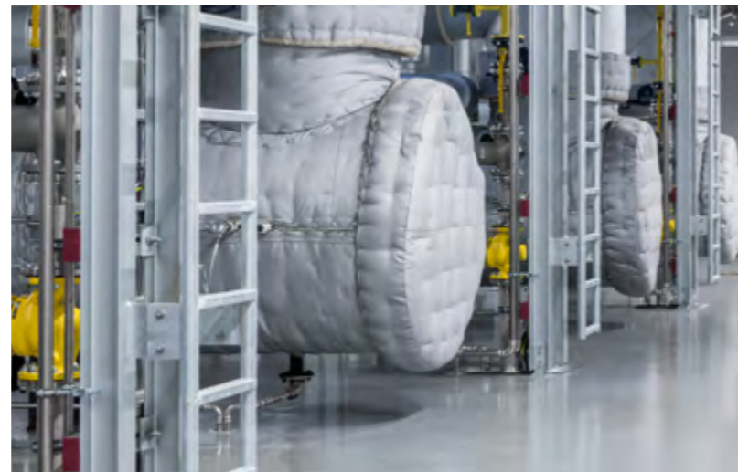
Neue Kraft-Wärme-Kopplungsanlagen in den BMW Werken Dingolfing und Landshut: Die CO 2 -Einsparung gegenüber konventioneller Technik beträgt künftig ca. 75.000 Tonnen im Jahr. Für diesen Beitrag zum Klimaschutz möchte der Konzern an beiden Standorten insgesamt rund 90 Mio. € investieren.
